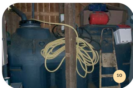
Stockage et pompage de l'eau pluviale.
