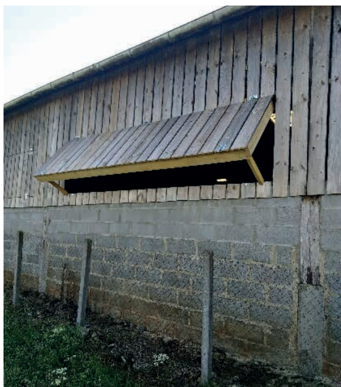
Photo 8 trappe protégeant du rayonnement (Crédit photo : Idele)
